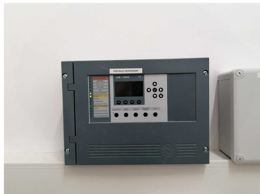
Foto centralina rivelazione palestra
