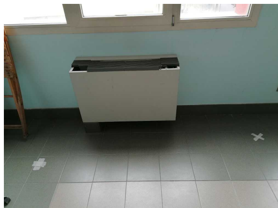
Foto ventilconvettori centro civico
